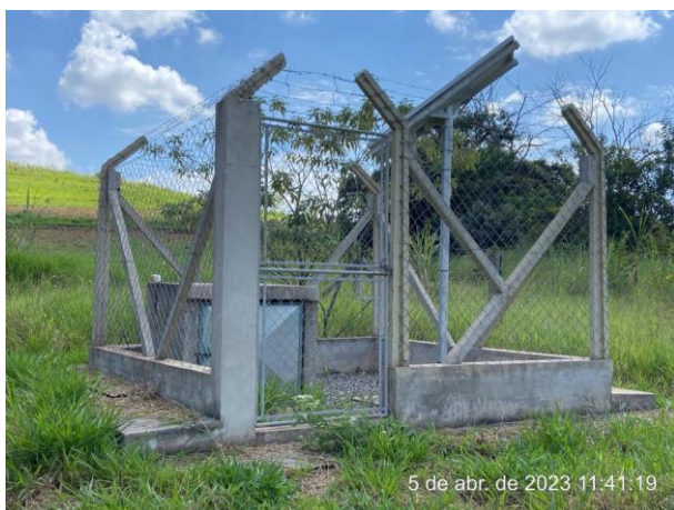
Foto 3 – Estação sismológica da Barragem Duas Pontes (Data:05/04/2023)
