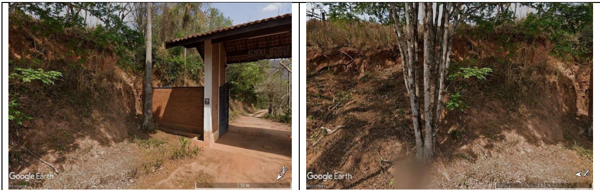
Fotos 4.2-1 e 4.2-2: Taludes de corte sem cobertura vegetal e diversos processos erosivos sobre os mesmos, no ano de 2021 (Street View Google).
