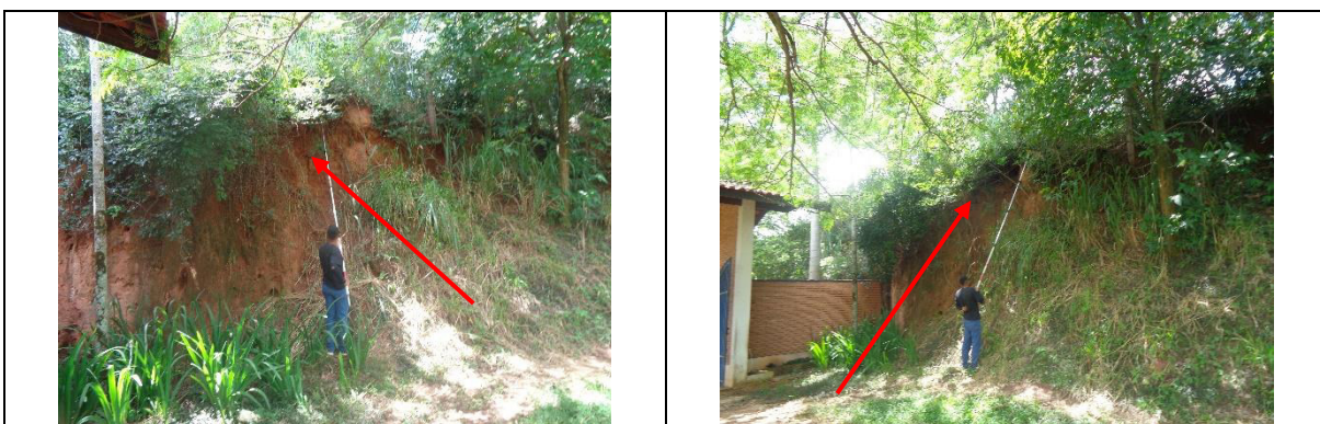
Fotos 4.2-7 e 4.2-8: As setas mostram talude de corte sub-vertical e com processos erosivos na crista do talude (abril/2023).
