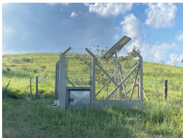
Foto 2 – Estação sismológica da Barragem Duas Pontes (Data: 16/03/2023)
